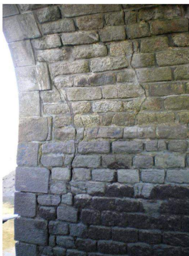
Photo 5 : fracturation à l'arrière du bandeau aval de la voûte centrale, côté rive droite.
