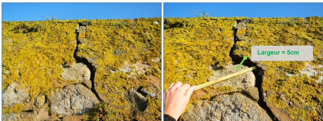
Fig. 11. Fissure B côté rive droite de l'étier (ARTELIA - 2016)
