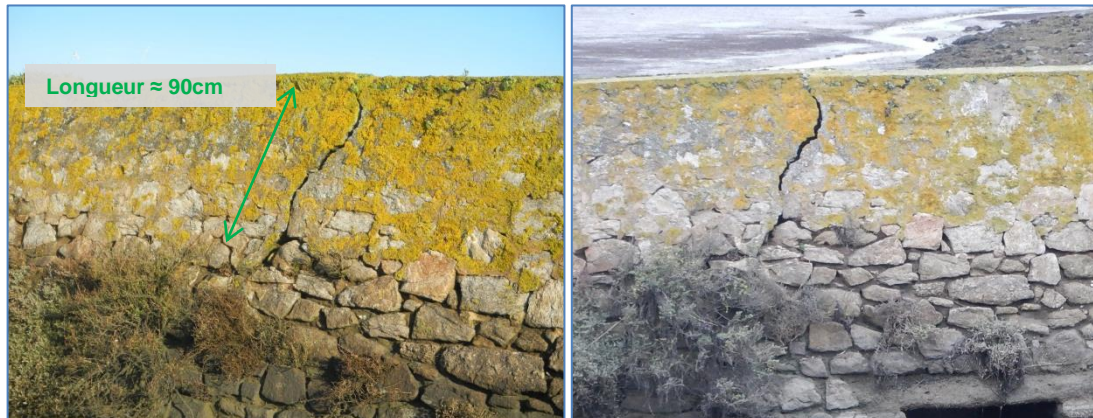
Fig. 10. Fissure A côté rive gauche de l'étier (ARTELIA - 2016)
