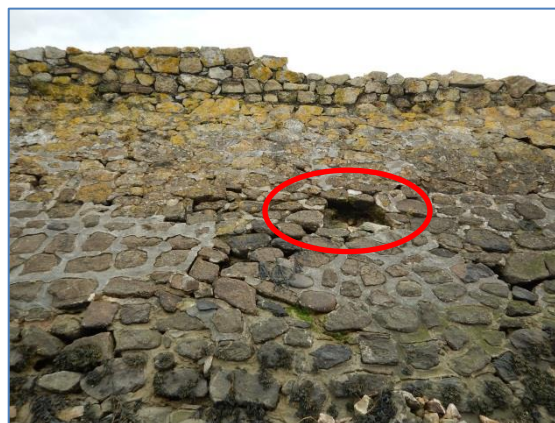
Fig. 22. Désordres sur le parement de la digue marine en rive droite dans le prolongement de l'ouvrage de Bérigo (ARTELIA – 2016)
