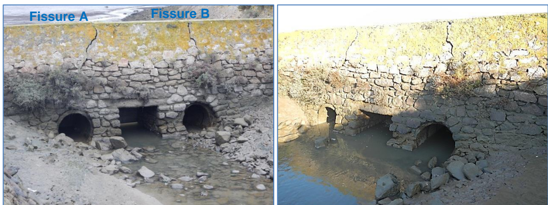
Fig. 9. Fissures (A et B) présentes sur le parement amont de l'ouvrage de Bérigo (ARTELIA - 2016)
