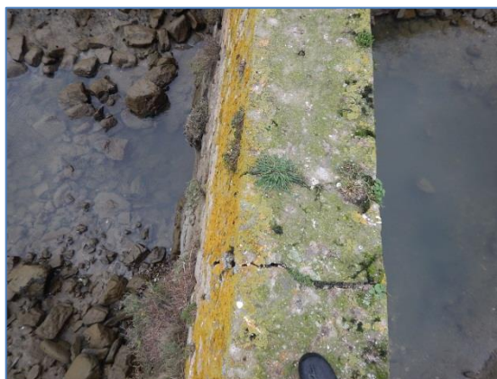
Fig. 18. Fissure C en crête de l'ouvrage de Bérigo (ARTELIA - 2016)
