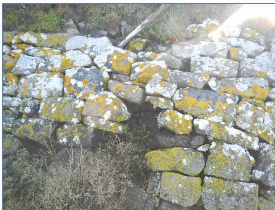
Fig. 20. Exemple de lacune observée sur le parement en pierres sèches des berges de l'étier de Bérigo (ARTELIA – 2016)
