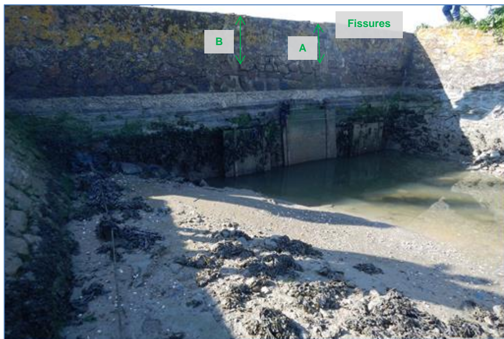
Fig. 16. Fissures (A et B) sur le parement aval de l'ouvrage de Bérigo (ARTELIA - 2016)
