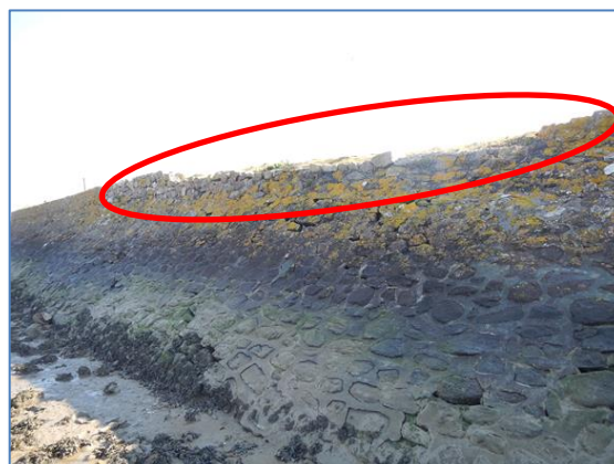
Fig. 23. Dégradations en crête de la digue marine en rive droite dans le prolongement de l'ouvrage de Bérigo (ARTELIA – 2016)
