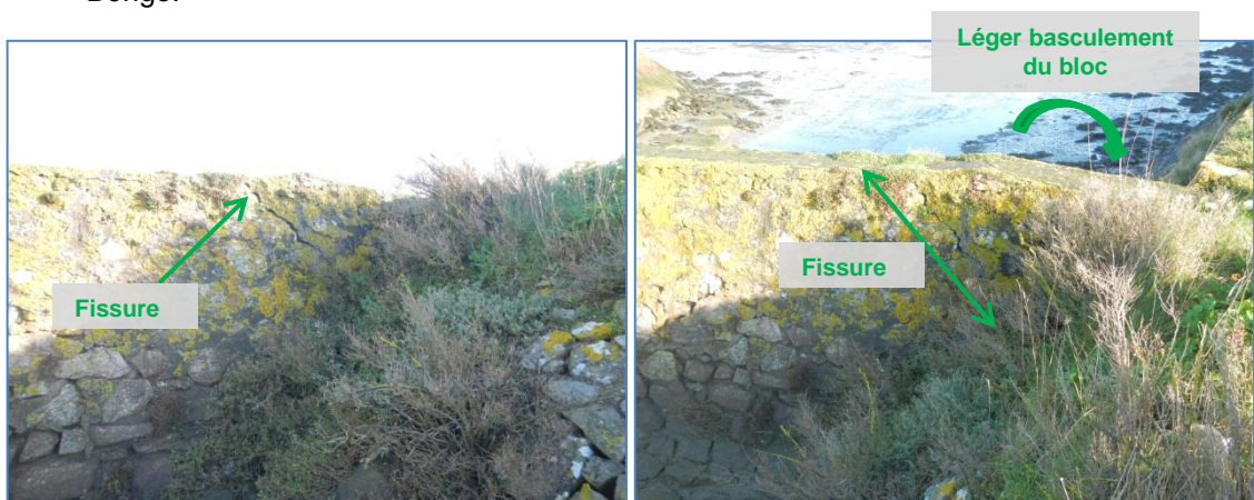
Fig. 12. Fissure C côté rive droite de l'étier (ARTELIA - 2016)
