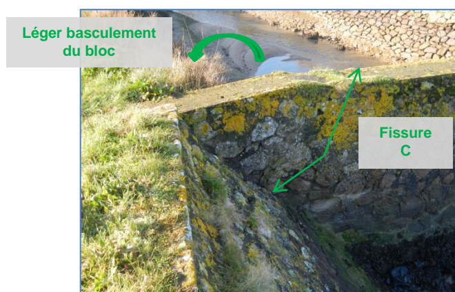
Fig. 17. Fissure C en rive droite sur le parement aval de l'ouvrage de Bérigo (ARTELIA - 2016)
