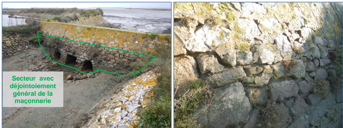
Fig. 13. Déjointoiements observés sur le parement amont de l'ouvrage de Bérigo (ARTELIA - 2016)
