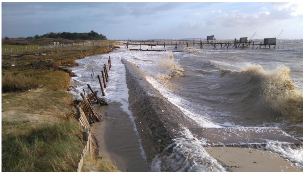
Figure 25 : Erosion du cordon dunaire par franchissement par-dessus la digue de Mainselle au Nord de la zone aquacole (Pornic Agglo Pays de Retz, épisode de tempête) le 9 mars 2016
